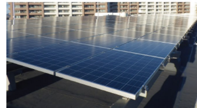
ソーラーパネルの設置状況
